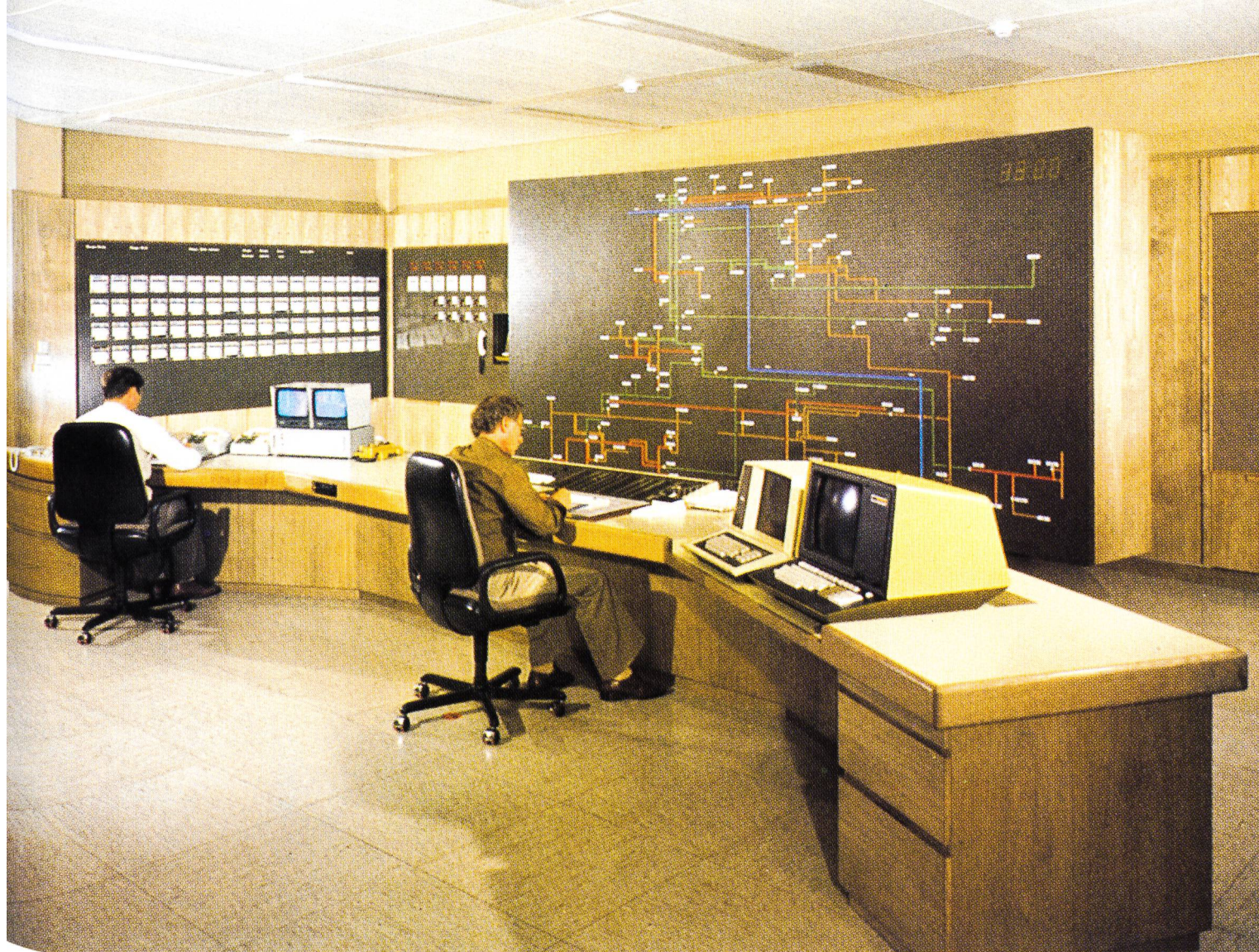
Zentrale Leitstelle für eine Industriegas-Verteilung in einem Chemieunternehmen (siehe auch den Bericht der Mauell AG, Buchs, über zukunftsorientierte Prozessautomatisierung).
