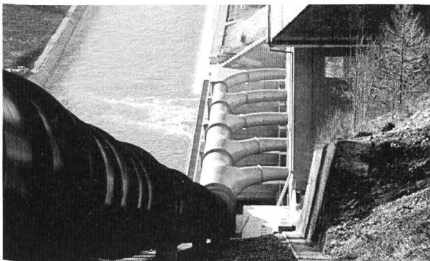
Figure 4. Vue de la partie à l'air libre de la nouvelle conduite forcée de Broc avec son répartiteur et la centrale d'origine.
