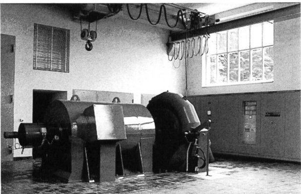
Bild 3. Neue Dotiermaschinengruppe 2430 kW in der Zentrale des Kraftwerkes Dallenwil. Bei der Turbine handelt es sich um die erste einer neu entwickelten Standardbaureihe der Firma Bell AG, Kriens.
