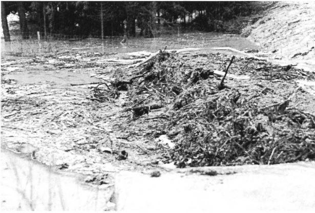
Bild 2. Nach dem Zurückgehen des Hochwassers ist der mit Rechenstäben abgedeckte Beckenentleerungseinlauf etwa einen Meter mit Geschwemmsel überdeckt. Der Haufen enthält wenig Zivilisationsabfall. Das Geschwemmsel, Laub und Äste, schwimmt an der Wasseroberfläche und beeinträchtigt deshalb bei Stau die Entleerung des Beckens nicht.
