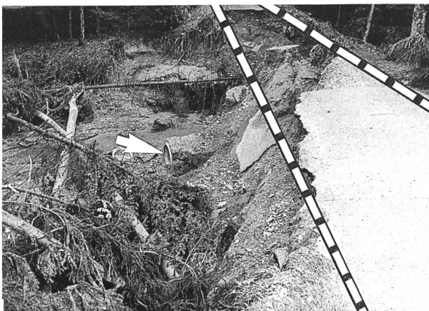
Bild 1. Kleine Ursache – grosse Wirkung: Durch Verstopfen eines Bachdurchlasses erfolgte ein Aufstau und anschliessend ein Überfließen des Strassendamms. Dadurch wurde die unterwasserseitige Böschung erodiert, was zur vollständigen Zerstörung von Damm und Strasse führte. In Bildmitte (Pfeil) ist das Ende des teilweise freigelegten Rohrdurchlasses zu erkennen. Die gestrichelten Linien rechts im Bild veranschaulichen das ursprüngliche Strassentrassée. Aufnahme in Willisau-Land nach dem Unwetter vom 16. Juni 1988. (Foto: Foto-Kino Schaller, Willisau)
