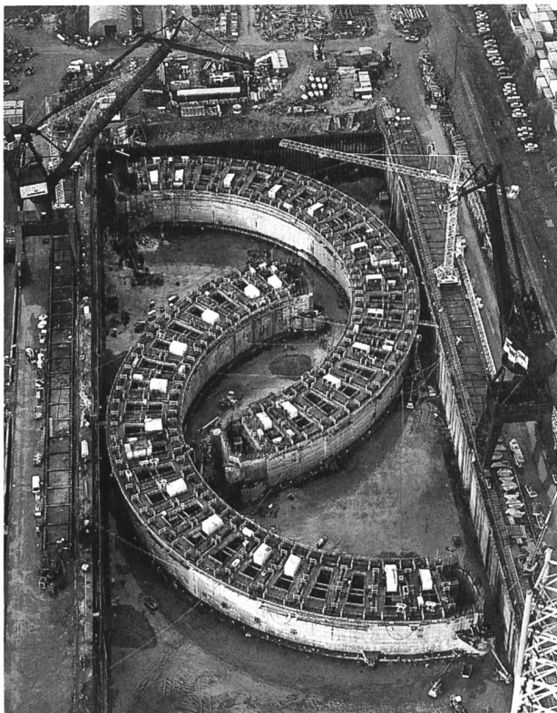
Bild 4. Betonieren des unteren Teils der beiden Wandteilstücke in einem Schiffsdock in den Niederlanden.
