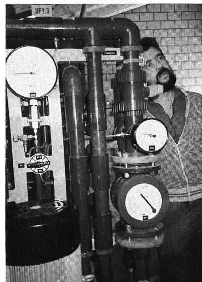
Bild 2. Druckeinrichtungen der Ultrafiltrationsanlage.
