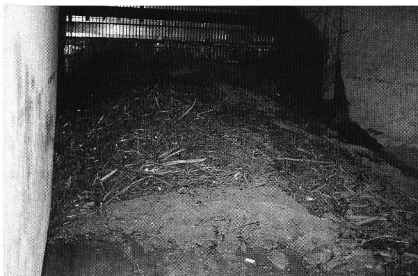
Bild 9. Geschiebeablagerung in den Turbineneinläufen.
