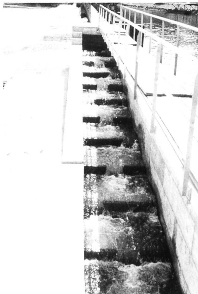
Bild 12. Beckenpass beim Reusskraftwerk Windisch.
