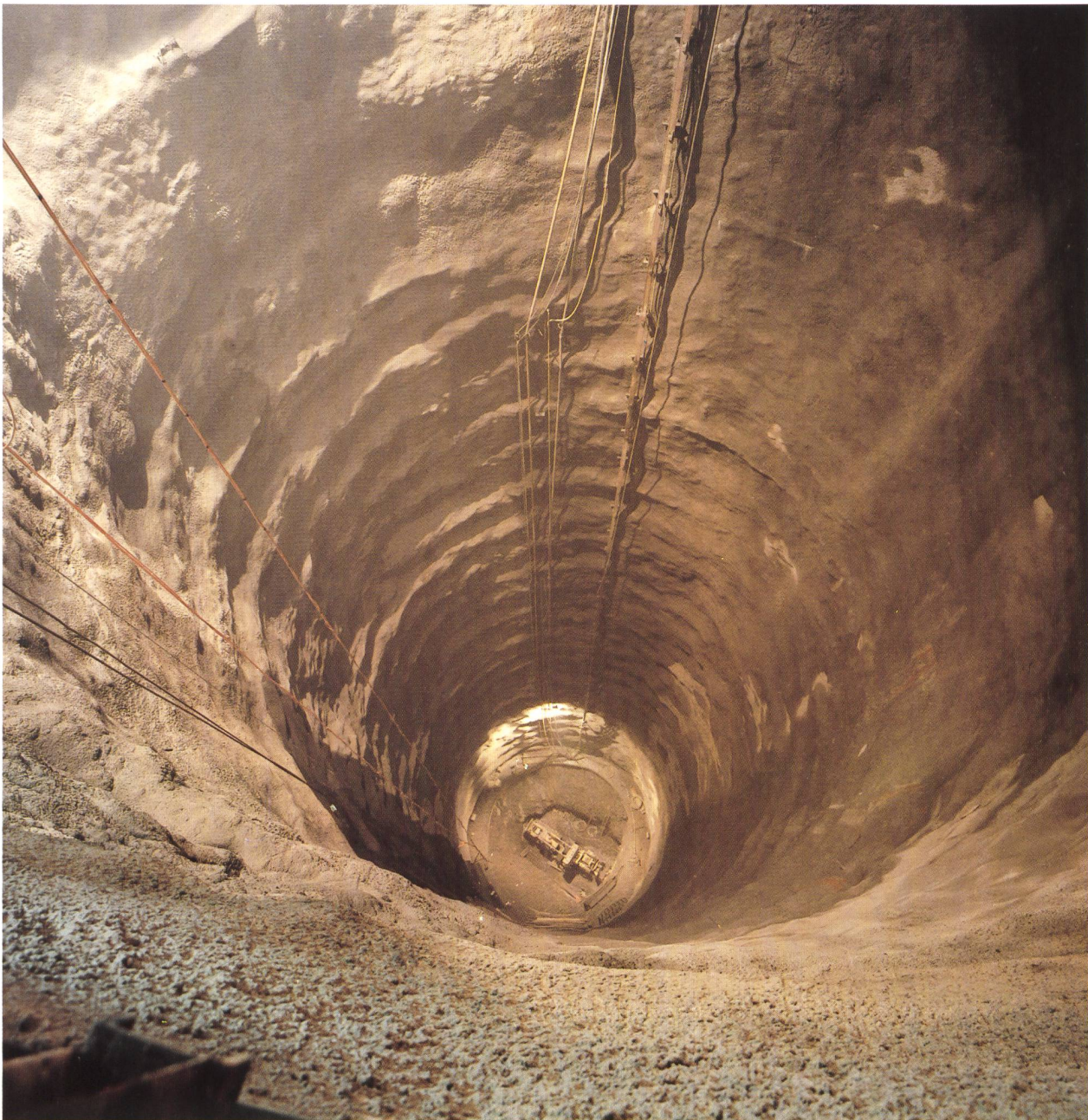
Bild 5.2. Der Ausbruch des Druckschachtes und des Vertikalschachtes erfolgte unter Anwendung des Raiseboring-Verfahrens. Die auf 2,10 m aufgeweitete Pilotbohrung diente zum Abtransport des bei der weiteren Ausweitung anfallenden Materials (Foto Wolf, Schruns).
