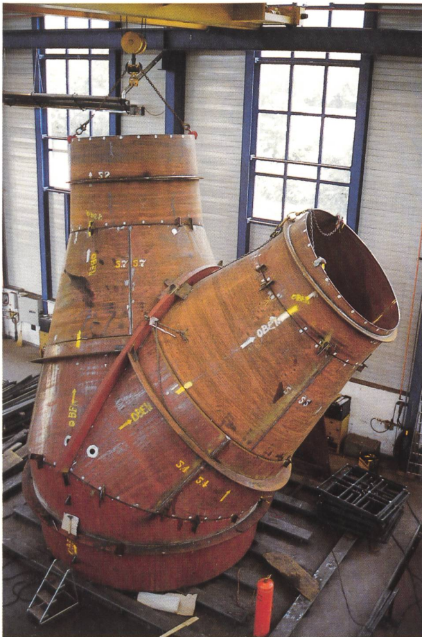
Bild 5.4. Die Endzone des Druckstollens, der Druckschacht sowie die beiden Verteilungen sind mit Stahl gepanzert. Die teilweise vormontierten Teile des Hosenrohres wurden vor Ort zusammengeschweisst. Die beiden Verteilungen und das Hosenrohr werden einer Druckprobe unterzogen.
