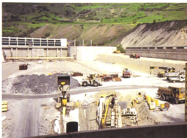
Bild 3.10. Das Ausgleichsbecken mit einem Nutzvolumen von 260000 \text{ m}^3 liegt in der ursprünglichen Ebene östlich der im Hintergrund abgebildeten Zentrale.
