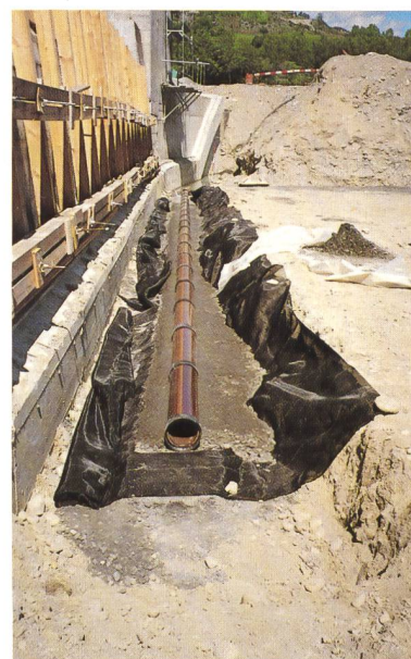
Bild 3.11. Querdrainageleitungen führen allfällige Sickerverluste zu den beiden begehbaren Sammelkanälen. Bedingt durch die grosse Aggressivität des Grundwassers, sind Steinzeugrohre verwendet worden.
