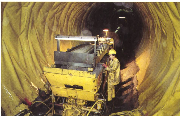
Bild 9. Nach dem Ausbruch wird das Stollenprofil mit Kunststoffbahnen abgedichtet, bevor der Beton eingebracht wird. Baulos San Niclà.
