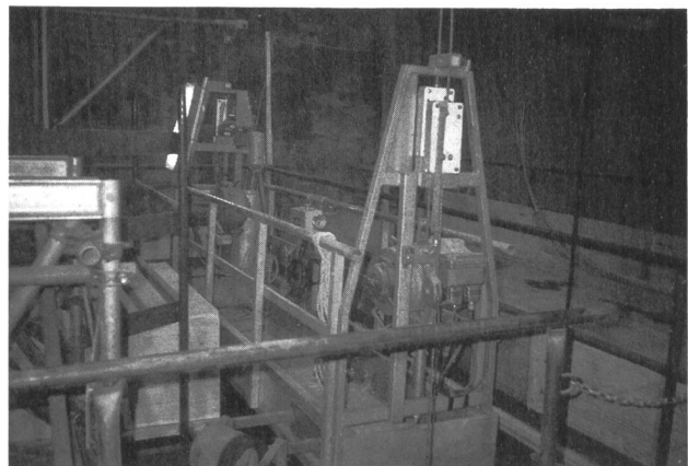
Bild 6. Motor-Hängegerüst für Personentransporte im Schacht.
