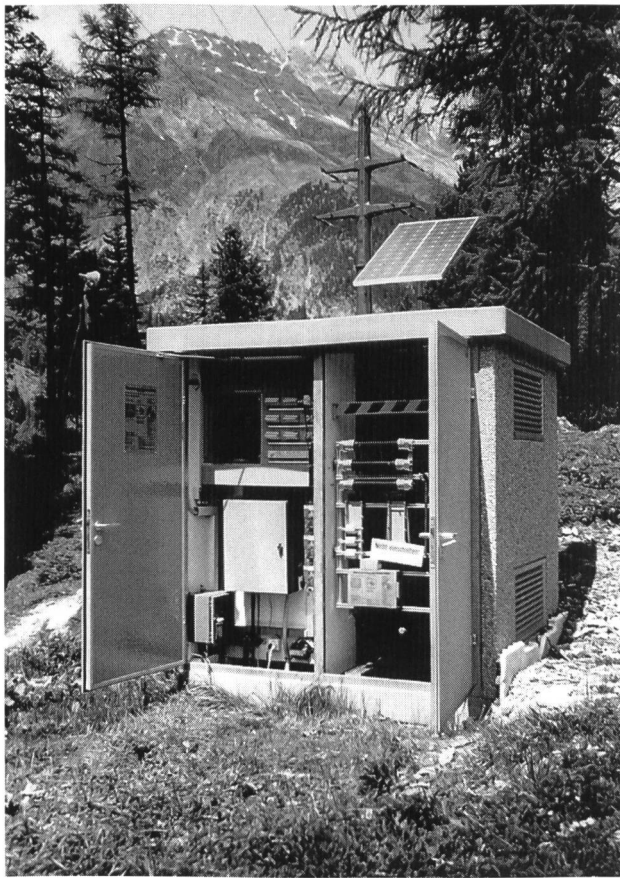
Bild 2. Transformatorstation Bergün-Toua. Da diese Station nur im Winter zur Beleuchtung der Schlittelbahn in Betrieb ist, musste zur Sicherstellung der Stromversorgung der Starkbebenstation während des Sommerhalbjahres eine Solaranlage installiert werden.
