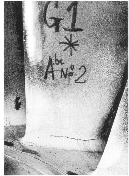
Figure 4. Fissure à l'attache d'une aube côté moyen.
