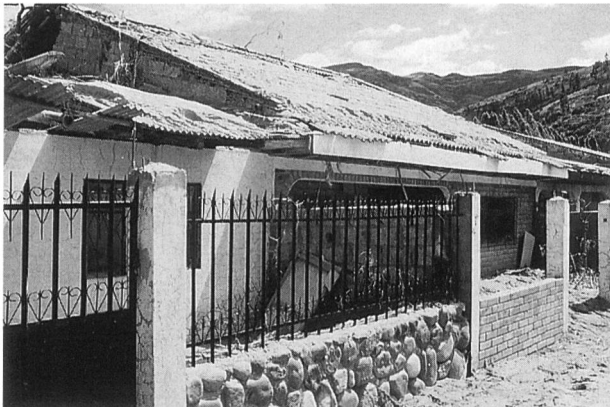
Bild 14. Schäden am Rande des Überschwemmungsgebietes. Teile von Paute zeigten nur Überschwemmungsschäden. Die Höhe der Wasserstände lässt sich am Sand auf den Hausdächern abschätzen.
