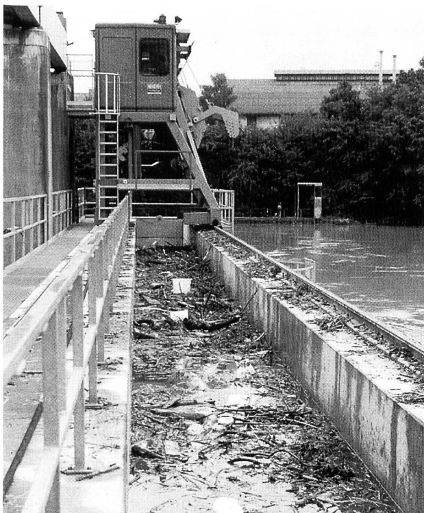
Renchérissent le prix de l'électricité et sont entre-temps jugés problématiques en termes biologiques: la récupération et le traitement des déchets flottants (naturels) sur les centrales au fil de l'eau.
