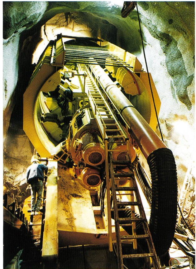
Bild 19. Montage der Startröhre für die Druckschachtfräse. Der Schacht ist 382 m lang und hat ein Gefälle von 85 %. Vom Fuss wurde der Schacht mit 3,8 m Durchmesser Richtung Wasserschloss gefräst. Nachher wurde der Schacht in Gegenrichtung auf 4,2 m aufgeweitet (Foto P. Mainardi vom 23. August 1995).
