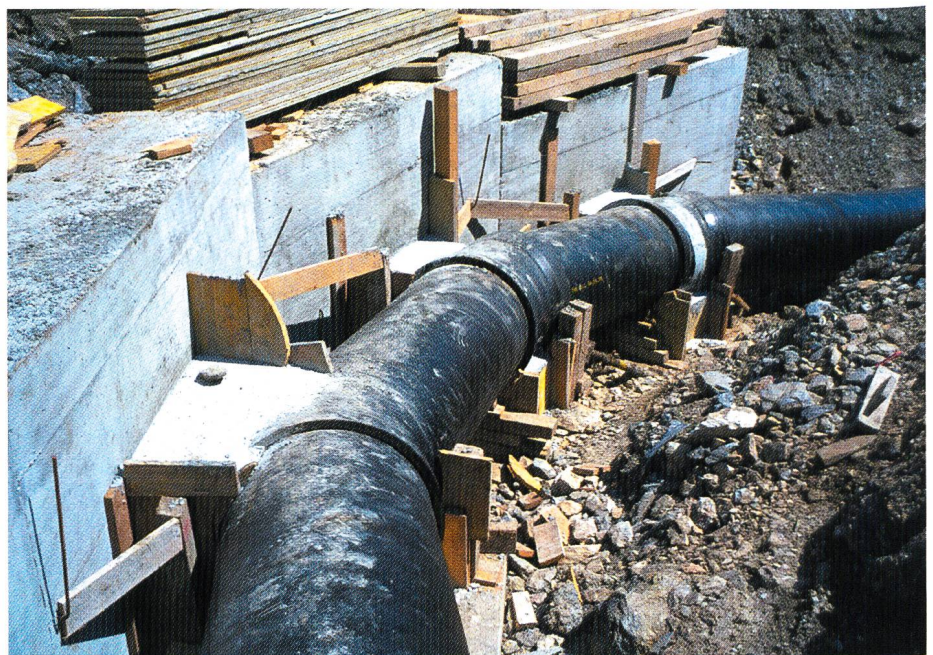
Bild 4. Das massive Betonwiderlager nimmt am Knickpunkt die riesige Auslennkraft der Druckleitung auf. Nach dem Auffüllen ist von allem nichts mehr zu sehen.
