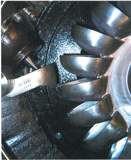
Bild 3. Blick von unten auf das Turbinenlaufrad und auf eine der fünf Düsen mit dem Strahlblecher.
