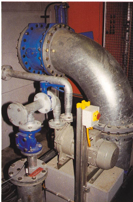
Bild 4. Standardpumpe für den Turbinenanlauf.
