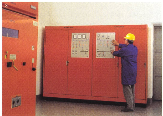
Bild 17. Kraftwerk Wildegg-Brugg: Nebensteuerstelle der Eigenbedarfs-Schaltanlage.
