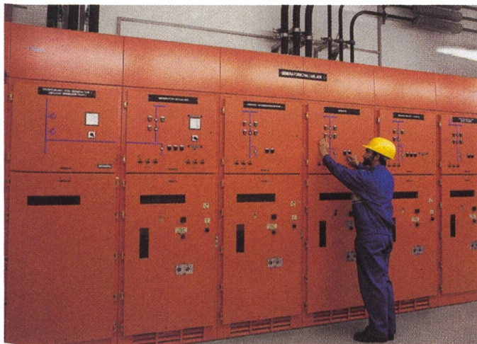
Bild 16. Kraftwerk Wildegg-Brugg: Neue, gekapselte 8-kV-Generator-Schaltanlage.
