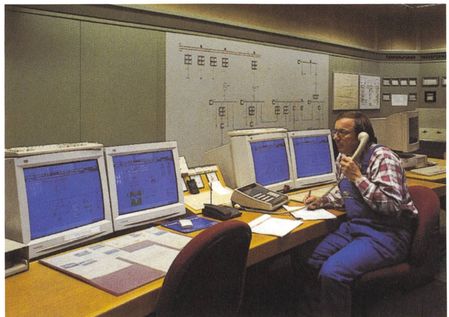
Bild 21. Kraftwerk Wildegg-Brugg: Neues Bediensystem im bestehenden Kommandoraum.
