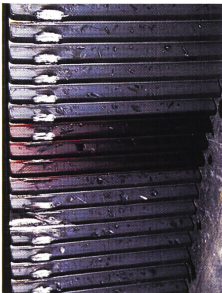
Bild 5. Tragbild an den belasteten Zahnflanken des Hohlrades der Maschine M2.
