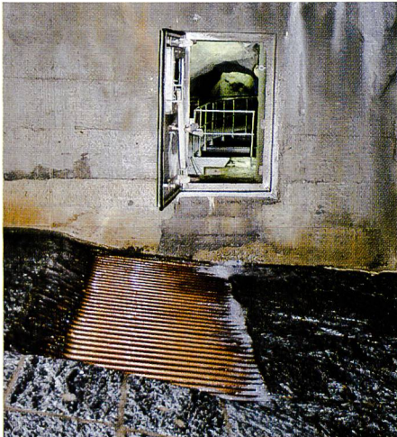
Bild 26. Tirolerfassung im Umleitstollen der Rovana. Einlaufrechen und Panzertüre in Richtung Entsanderkammer.
