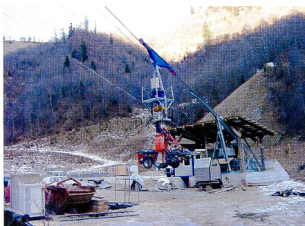
Bild 28. Talstation der Personen- und Materialseilbahn zur Erschliessung der Wasserfassung.
