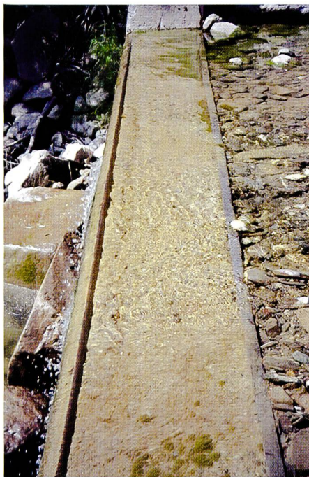
Bild 7. Muldenförmige Abrasion auf einem Wehrrücken.
