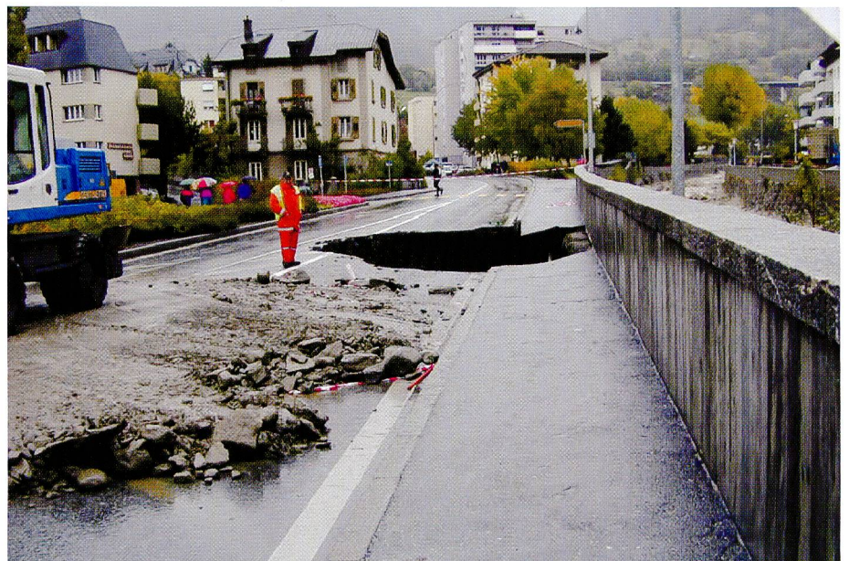
Bild 14. Einbruch der Ufermauer bei einer Sperre am 15. Oktober 2000 (Foto A. B.).
