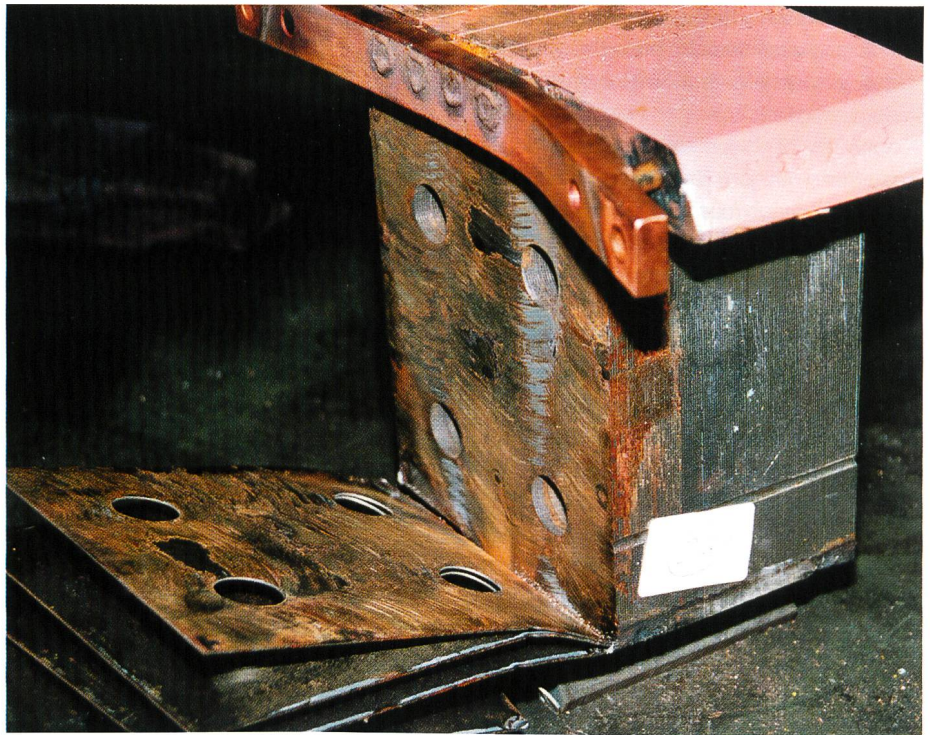
Bild 8. Durch Rost beschädigter Pol eines Generators.
