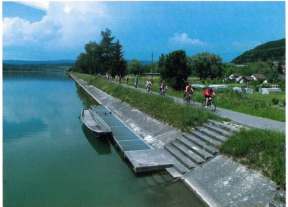
Bild 7. Sicherheit für die Anlage wie auch für alle Nutzniesser dank Kontrolle und Unterhalt.
