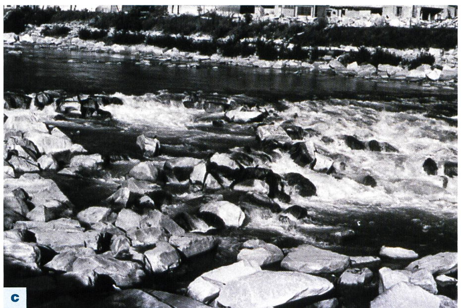
Bild 2. Schwelle bei Lodrino am Ticino: a) beschädigte Rampe, ca. 1983; b) aufgrund von Modellversuchen neu gebaute massive Rampe, ca. 1986; c) im Hochwasser von Juli 1987 teilweise beschädigte Rampe.
