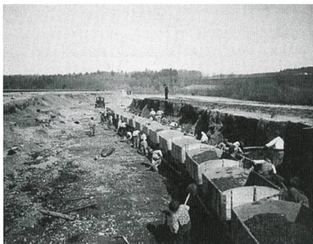
Bild 1. 1901: Bevor die erste Glühbirne von Bannwil aus mit Strom versorgt werden konnte, mussten die Arbeiter ihre Energie beim Kanalaushub einsetzen.
