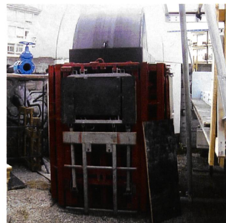
Figure 13. Volume plongeur installé sur le bassin amont.
