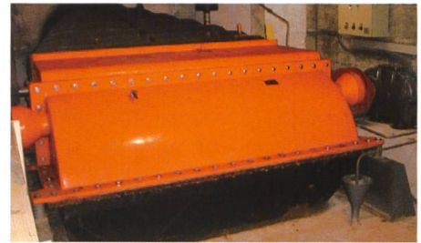
Bild 8. Mit der horizontal gelagerten Schaufelrad-Turbine wird in der «alten Sägerei» eine Wassermenge von ca. 1,2 m 3 /s zur Stromerzeugung genutzt.
