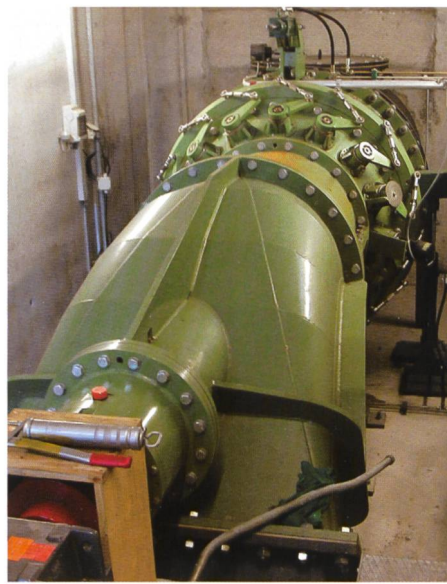
Bild 6. Beim ersten, neu erstellten Kraftwerk am Mühlbach versorgt ein 200 m langes Druckrohr die Rohrturbine mit einer Wassermenge von 1,8 m 3 /s. Damit werden jährlich rund 550 000 kWh Strom erzeugt.
