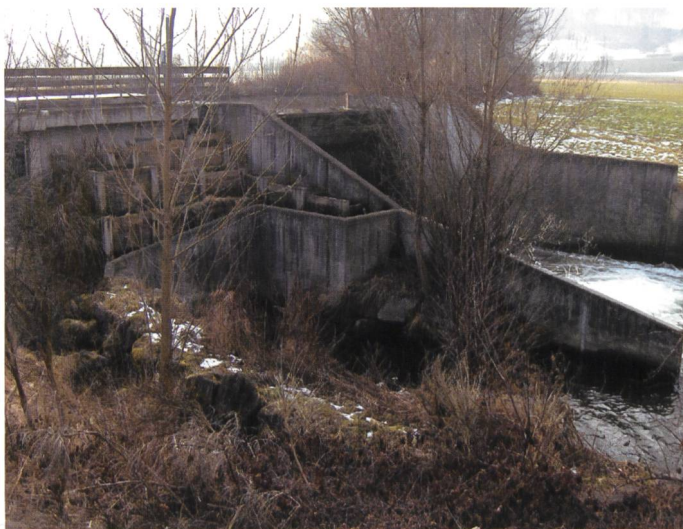
Bild 5. Das Kleinwasserkraftwerk in Lotzwil (bei Langenthal) nutzt eine kleine Geländestufe zur Erzeugung erneuerbarer Elektrizität.
