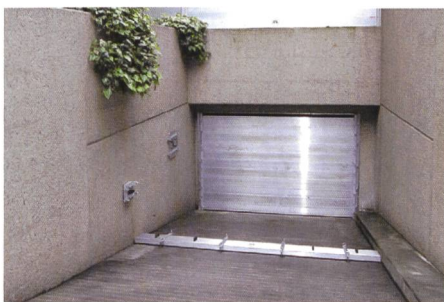
Bild 3. Garageinfahrt vollständig geschützt, Locarno TI.
