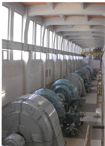
Bild 6. Maschinenhalle PSW Waldeck 1.
