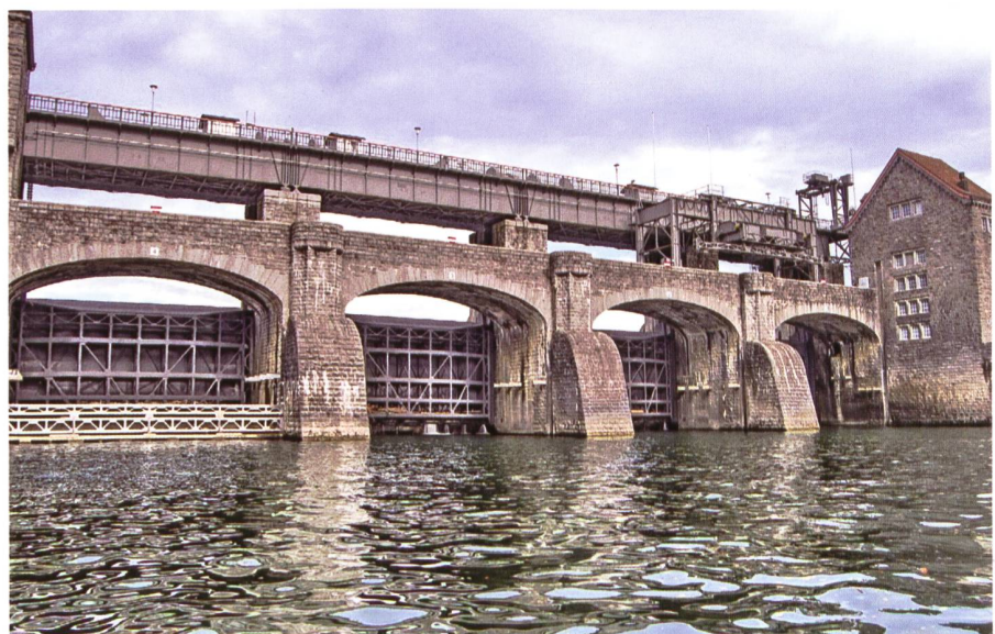
Bild 11. Die obere Hälfte der Wehranlage, die aus dem Unterwasser ragt, wurde durch den Umbau nicht verändert.
