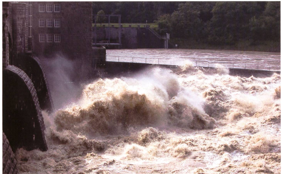
Bild 10. Die Wehranlage mit rund 2200 m 3 /s durch zwei Wehrfelder. Im Vordergrund Wehrfeld 3 ohne Abfluss, aufbäumende Wassermassen beim alten Wehrfeld 2 und die lange Dissipationszone nach dem umgebauten Wehrfeld 1 (vor der Betonleitwand zum Kraftwerksauslauf).
