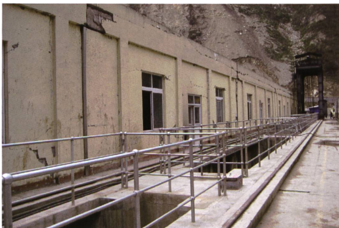
Bild 7. Wehranlage Yingxiuwan: Schäden am Wehrbauwerk.
