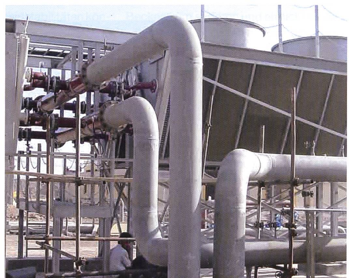
Bild 10. Verrohrung Assalouyeh Power Plant.
