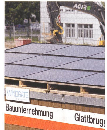
Solarpanels auf dem Baucontainerdach.
