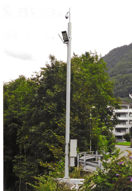
Bild 5. Beleuchtung und Elektroinstallationen.
