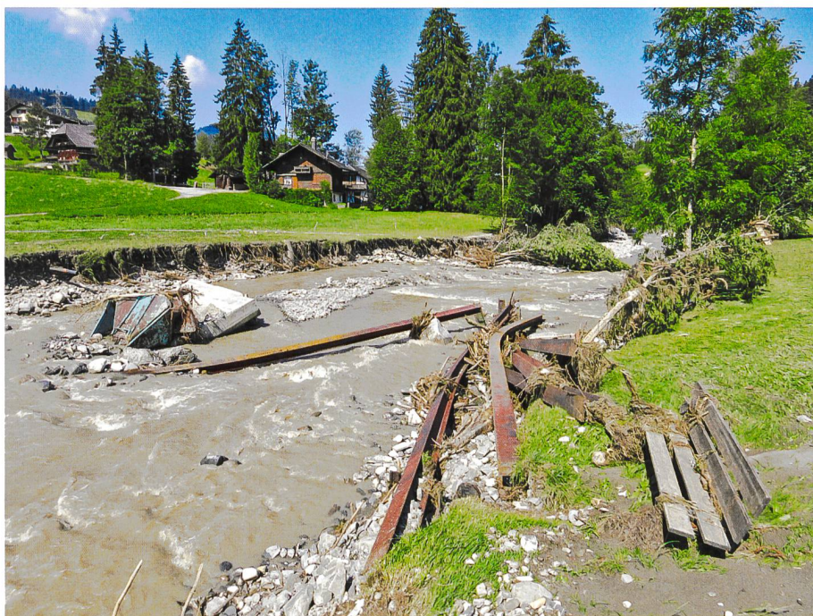
Bild 1. Weggeschwemmte Büetschlibrücke bei Bumbach Dorf in der Gemeinde Schangnau (Foto: Geotest AG).
