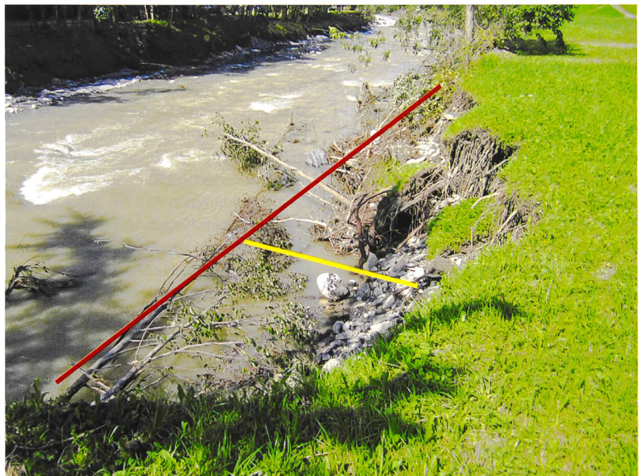
Bild 5. Vermessung der Böschungserosion: die rote Linie bezeichnet die Länge, die gelbe Linie die Breite der betroffenen Fläche (aus Zurbrügg 2015).
