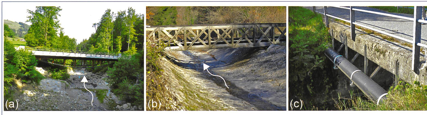
Bild 6. Beispiele für Brücken im Projektperimeter mit einer ungünstigen Geometrie: (a) Unterzugkonstruktion der Hergiswaldbrücke II, (b) Fachwerkkonstruktion der SBB Brücke, (c) Werkleitung an der Fischereibachbrücke.
