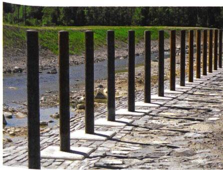
Bild 13. Die Rechenstäbe aus Stahl sind ausbetoniert und oben mit einer Stahlkappe geschlossen. Die leicht vorstehenden Köcherfundamente zeigen die Verankerung der Rechenstäbe im Fundament. Die Stäbe des Querrechens stehen auf Terrainhöhe des Rückhalteriums.
