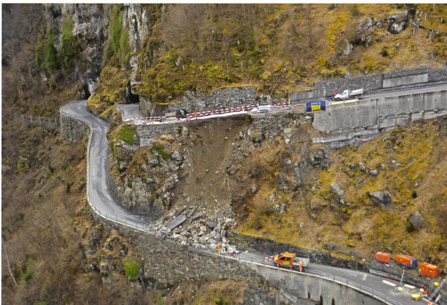
Bild 6. Ein 10 m langes Teilstück der Kantonsstrasse von Amsteg nach Bristen UR stürzte am 5. März ab (Foto: Baudirektion, Kanton Uri).
