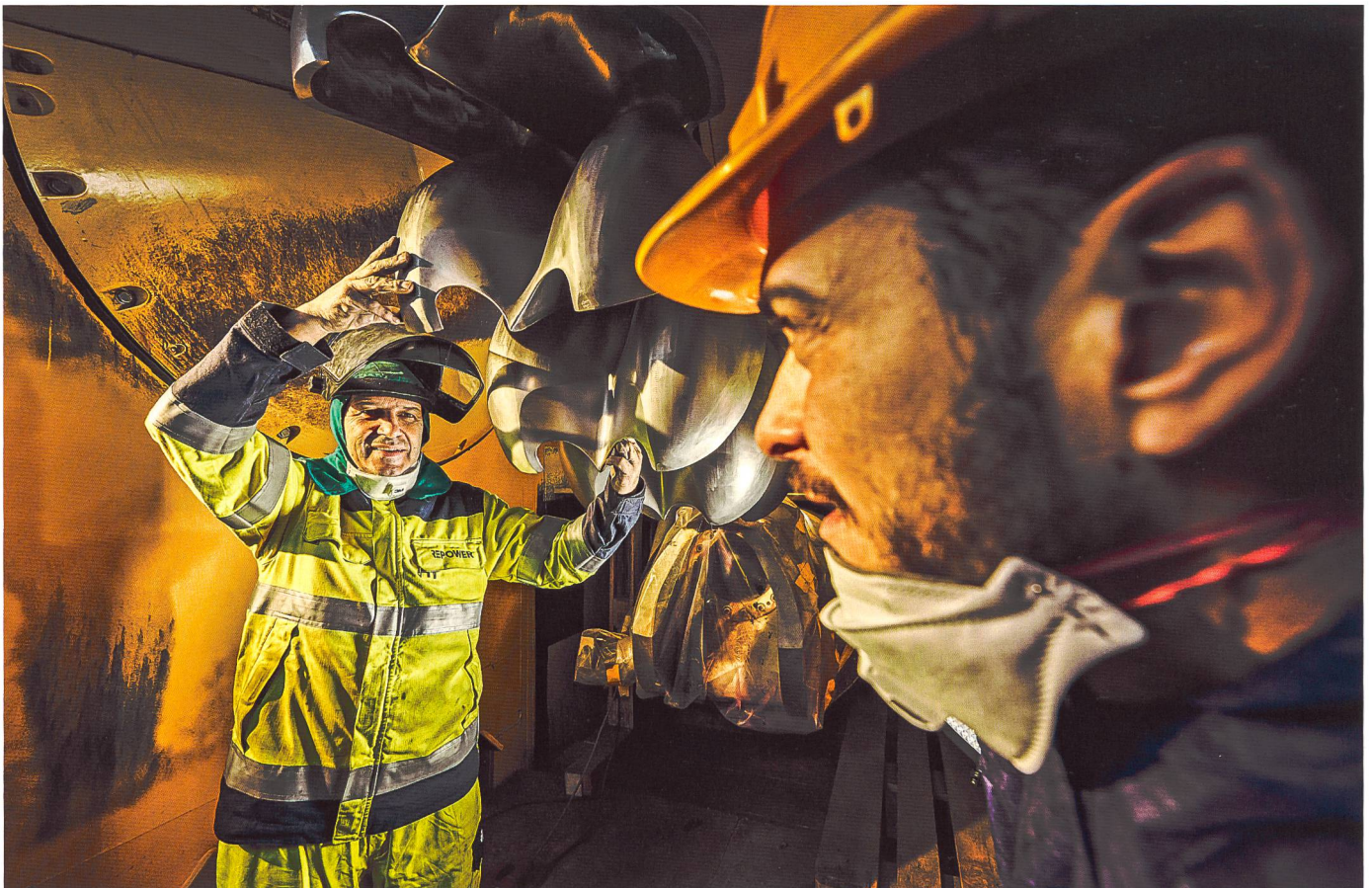
Experten im Einsatz: Repower-Mitarbeiter warten eine Turbine.
