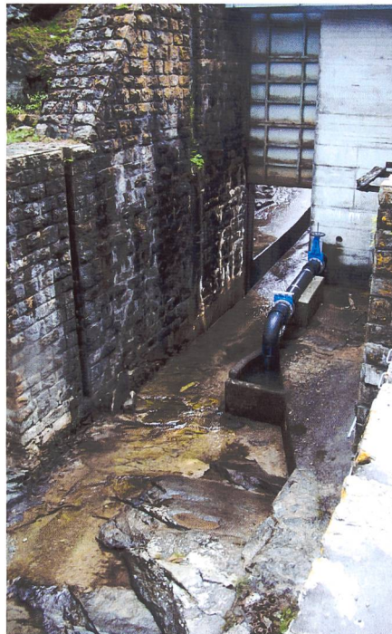
WF Puntalta, Tafelschütz Grundablass und Dotiereinrichtung.
