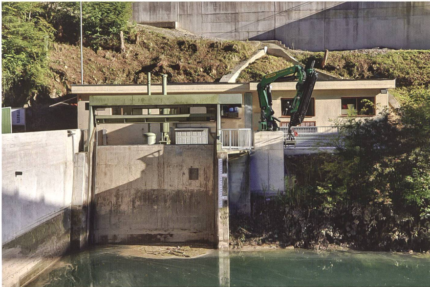
Bild 19: Rechenanlage beim Einlauf zum Druckstollen (links) mit neuem Schwemmholzkran inkl. Fundament (rechts) vor dem Betriebsgebäude.
