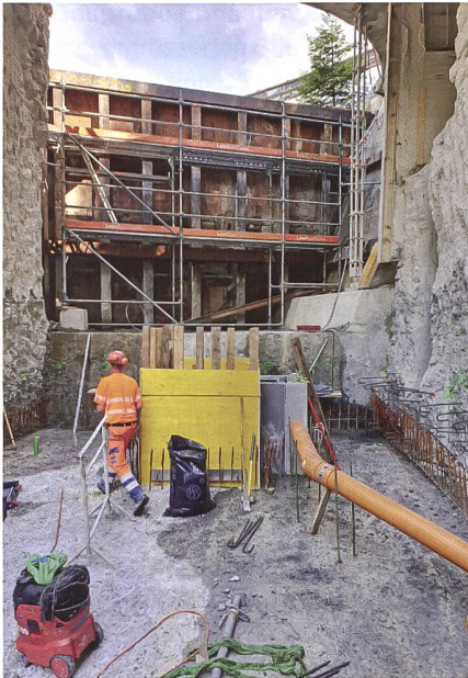
Bild 10: Errichtung des Zylinderschachtes und des Schwellenriegels im Schutz der Bauwand (Blick Richtung Oberwasser).
