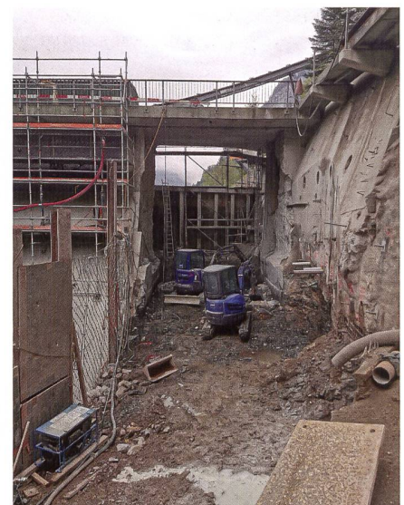
Bild 13: Betonabbruch/Felsausbruch mit Kleinbagger und Abbauhammer im Stauklappenbereich. Im Hintergrund ist die Bauwand zu erkennen (Blick Richtung Oberwasser).
