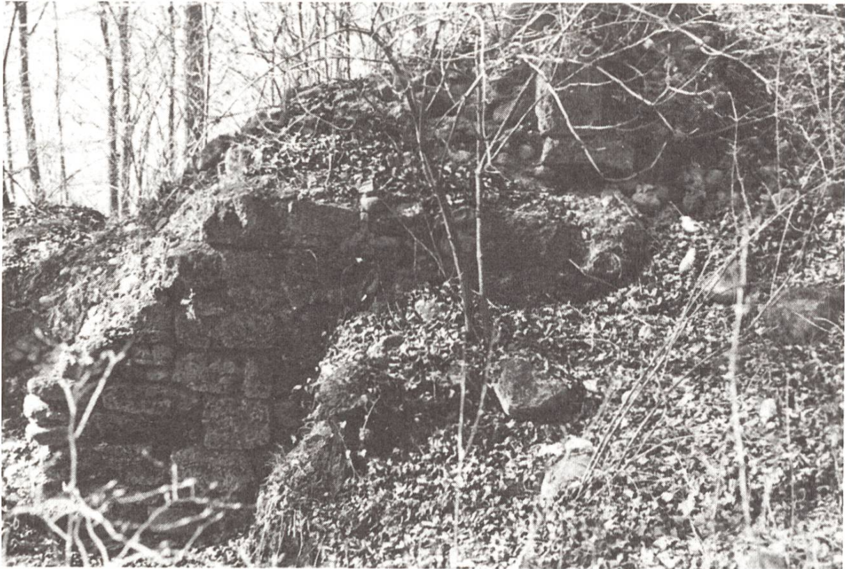
Reste der Mauern beim Eingang. Man sieht unten den vermauerten ersten Eingang und oben rechts der rechtsseitige Teil des Türgewandes.
