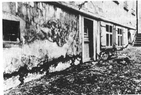
Situation 1959, vor Mauerentfeuchtung
