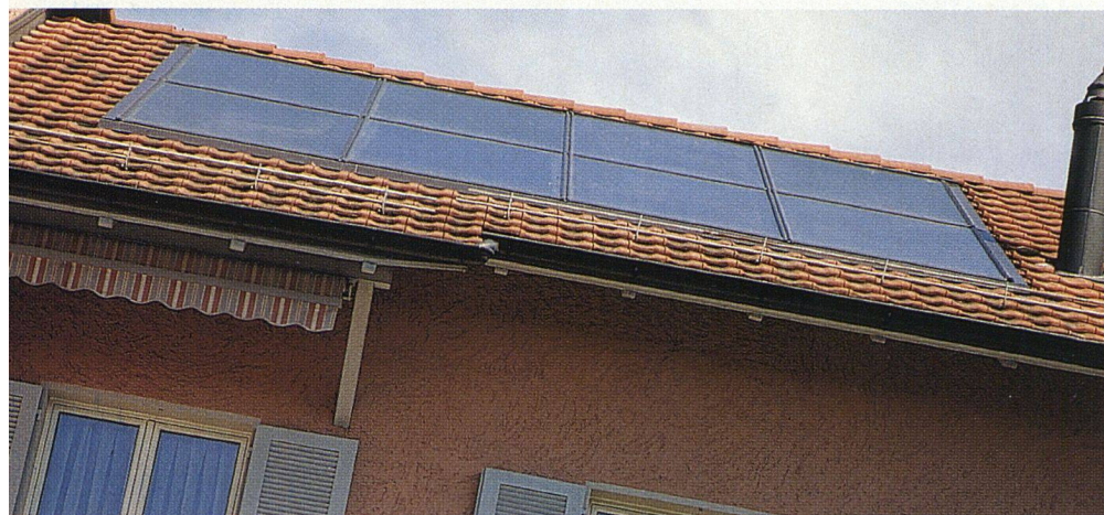
Die Solaranlage auf dem Dach der Liegenschaft Römerweg in Effretikon hilft beim Heizen und liefert Energie fürs Warmwasser.
