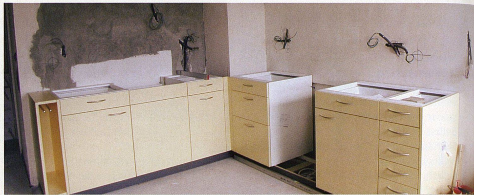
Bei der Küchenmontage müssen Schreiner, Sanitär, Elektriker, Plättlileger und Maler koordiniert werden. Das verlangt Flexibilität, Organisationstalent und Fachwissen.
