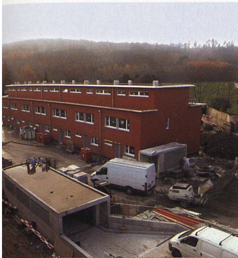
Auf der neu erstellten Tiefgarage (Einfahrt im Vordergrund) entstanden zwei Zeilen Reihenhäuser.
