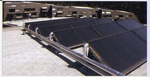
Auf den Dächern der Bauten sind je 112 Quadratmeter Solarkollektoren installiert, die an sonnigen Tagen das Warmwasser erwärmen.
