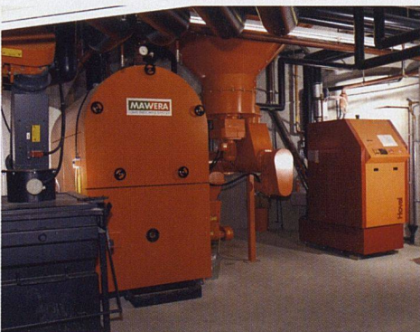
Das mächtige, 100 Kubikmeter fassende Holzschnitzkessel ist in der spiralförmigen Zufahrt zur Tiefgarage untergebracht.
